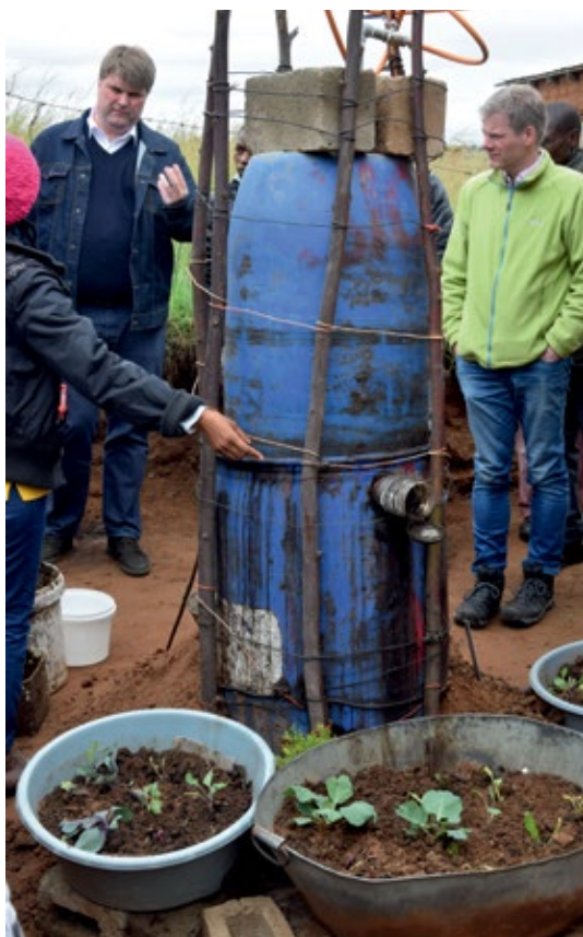
Installation de biogaz à Matatiele District Municipality © District de Hameln-Pyrmont
